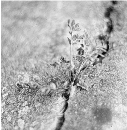
Murrutan på Ängsholmen 1984. En av flera plantor på den sydostvända klippväggen som får fuktighet från vatten som sipprar från ovanliggande cementgjutningar.
